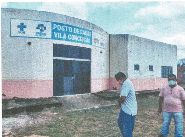
Foto 03: Porta da entrada quebrada.
