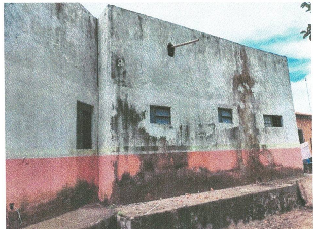
Foto 02: Parte externa deteriorada
