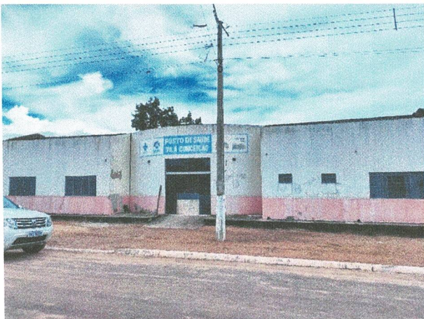
Foto 01: Pintura externa deteriorada
