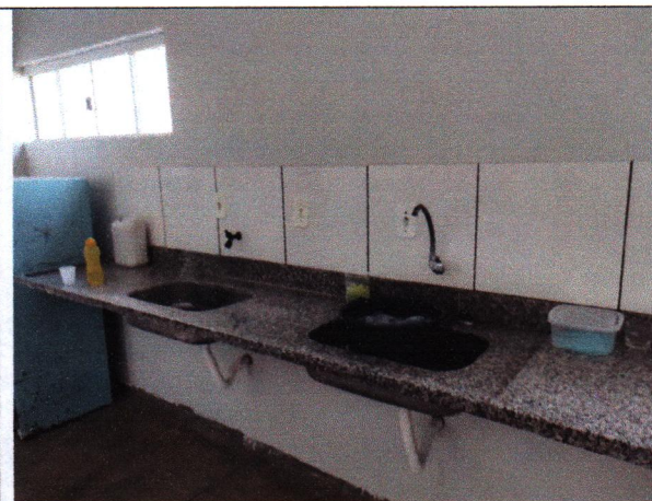
Foto 08: Torneiras da pia com defeito.
