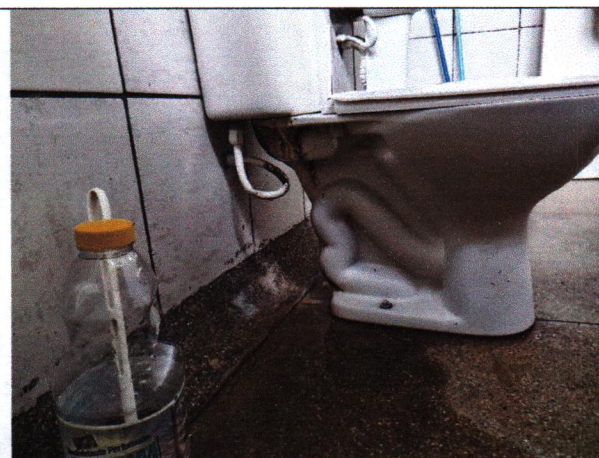
Foto 07: Ponto de água com vazamento.
