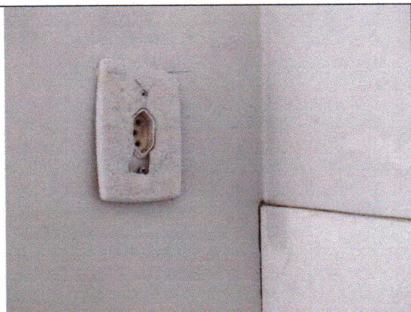
Foto 05: Ponto de tomadas com avaria.
