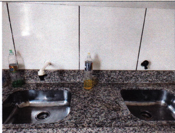
Foto 04: Torneiras com defeito.
