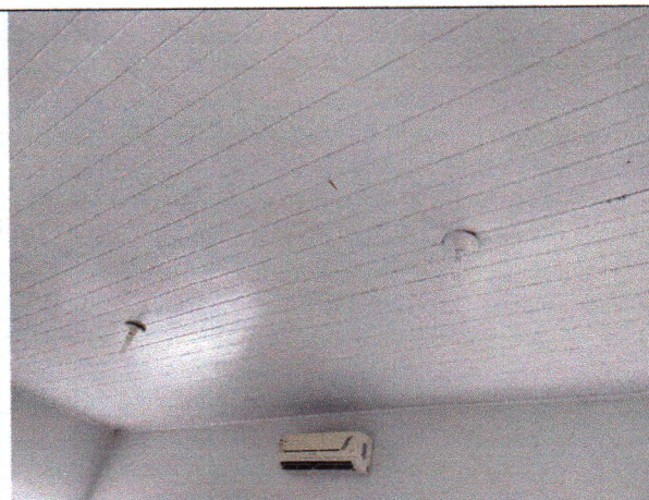
Foto 06: Deficiência na iluminação.
