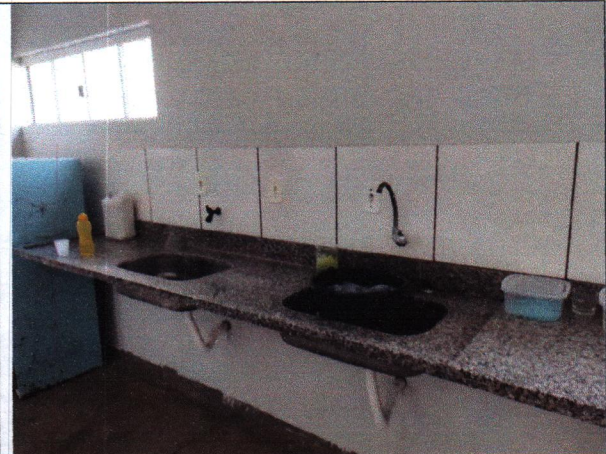
Foto 08: Torneiras da pia com defeito.
