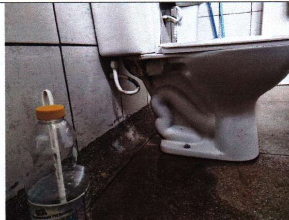
Foto 07: Ponto de água com vazamento.
