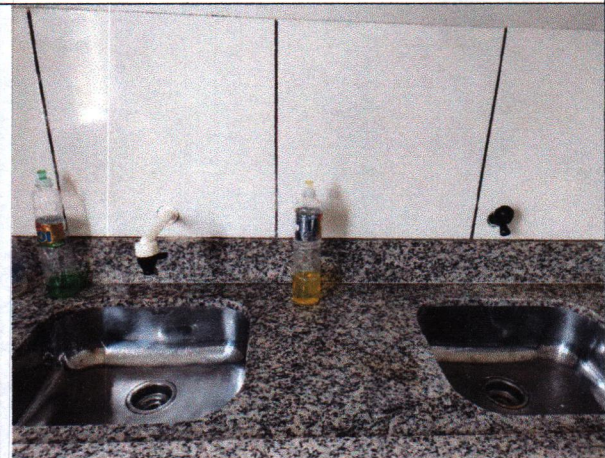
Foto 04: Torneiras com defeito.
