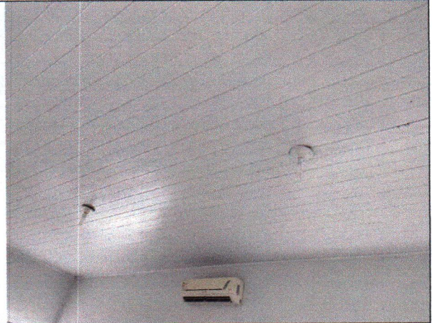
Foto 06: Deficiência na iluminação.
