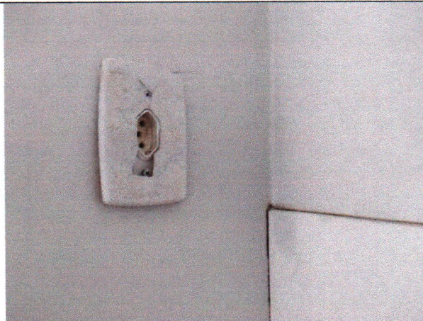
Foto 05: Ponto de tomadas com avaria.
